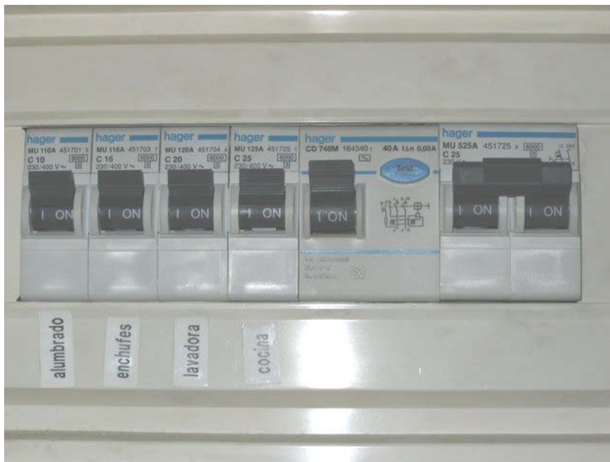
Cuadro general de distribución de una vivienda unifamiliar.
