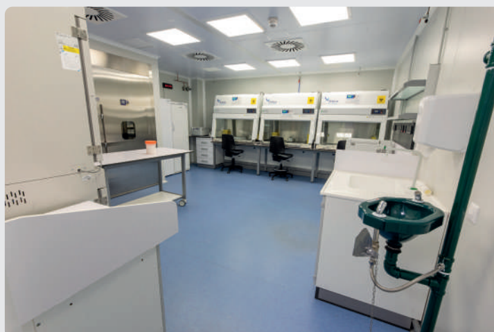
SALA DE RIESGO BIOLÓGICO 3
