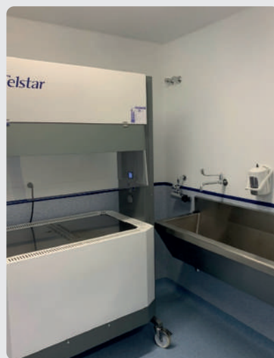
ZONA DE PREQUIRÓFANO (LAVABO MEDICAL Y CABINA DE BIOSEGURIDAD)
