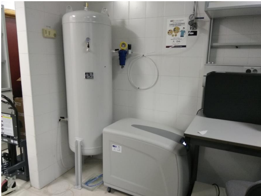
Generador y tanque de nitrógeno de alta pureza
